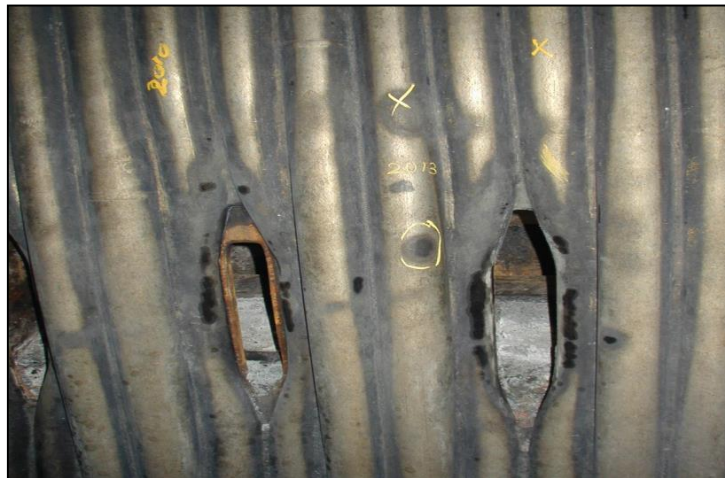
Figur 2. Missfärgade områden (svart yta) på det rostfria skiktet som kräver tubbyte på grund av risk för vattensidig korrosion.
