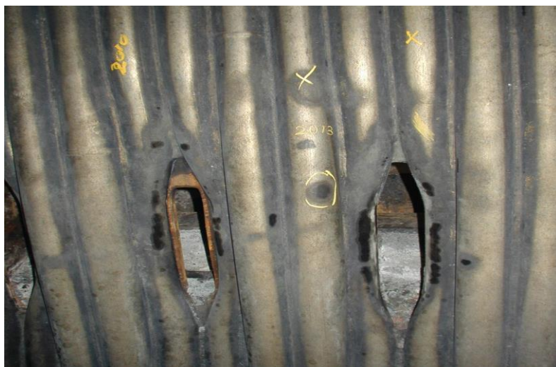
Fig. 1: Missfärgade rostfria ytor som kräver tubbyte pga. risk för vattensidig korrosion
