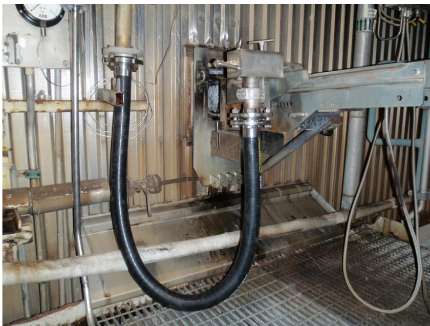
Bild 2 Anslutande slang för lut är fast monterad för minimal påverkan och slitage på slang i samband med sprutbyte.
